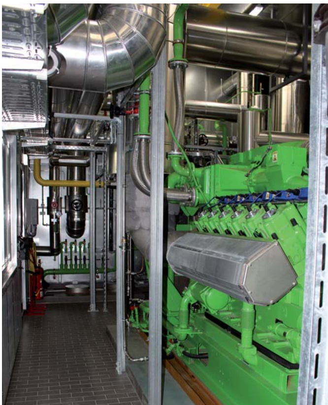
Innenansicht BHKW mit Motor (Westansicht)
